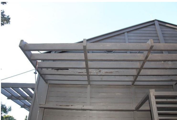
Slika 23_Stanje pergole i horizontalnog istaka_proljeće 2024. godine_Kuća B
