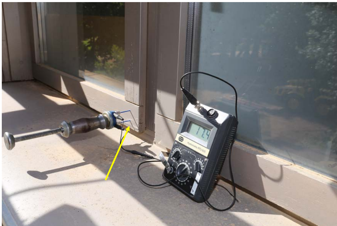
Slika 26. Na južnoj strani je isušivanje prozora brže, ali i ovdje se mjestimično primjećuje trulež i mjehuranje odnosno ljuštenje površinskog premaza. Sadržaj vode i ovdje iznosi visokih 17- 18 %, što uzrokuje supstituciju adhezivne veze premaza vodom, pa se vidi mjehuranje premaza.
