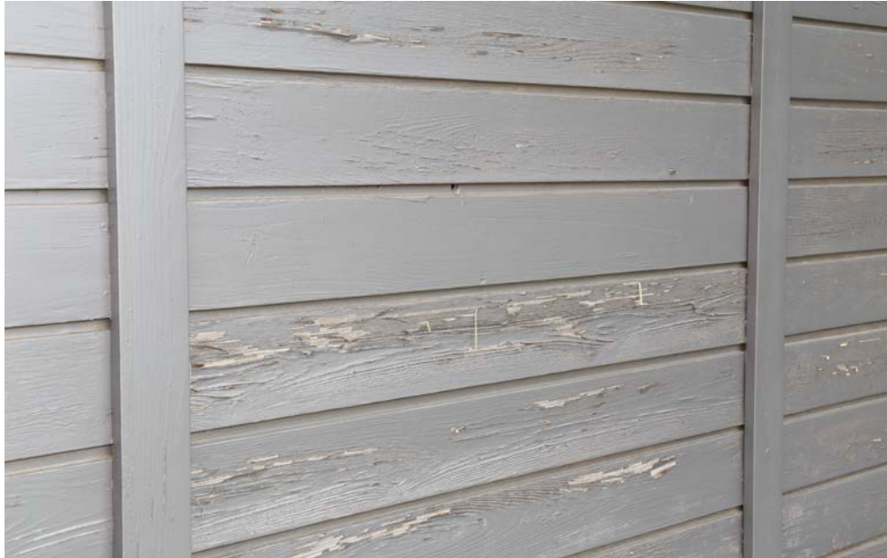
Slika 10. Pročelje na zapadnoj strani nakon samo pet godina pokazuje greške slabe adhezije premaza, naročito na daskama tangentne teksture (bočnicama). Ovo može biti posljedicom nepravilne pripreme površine nakon pjeskarenja prvotnog sloja boje (izostanak brušenja), potpomognuto visokim površinskim temperaturama na zapadnoj strani tijekom ljeta.
