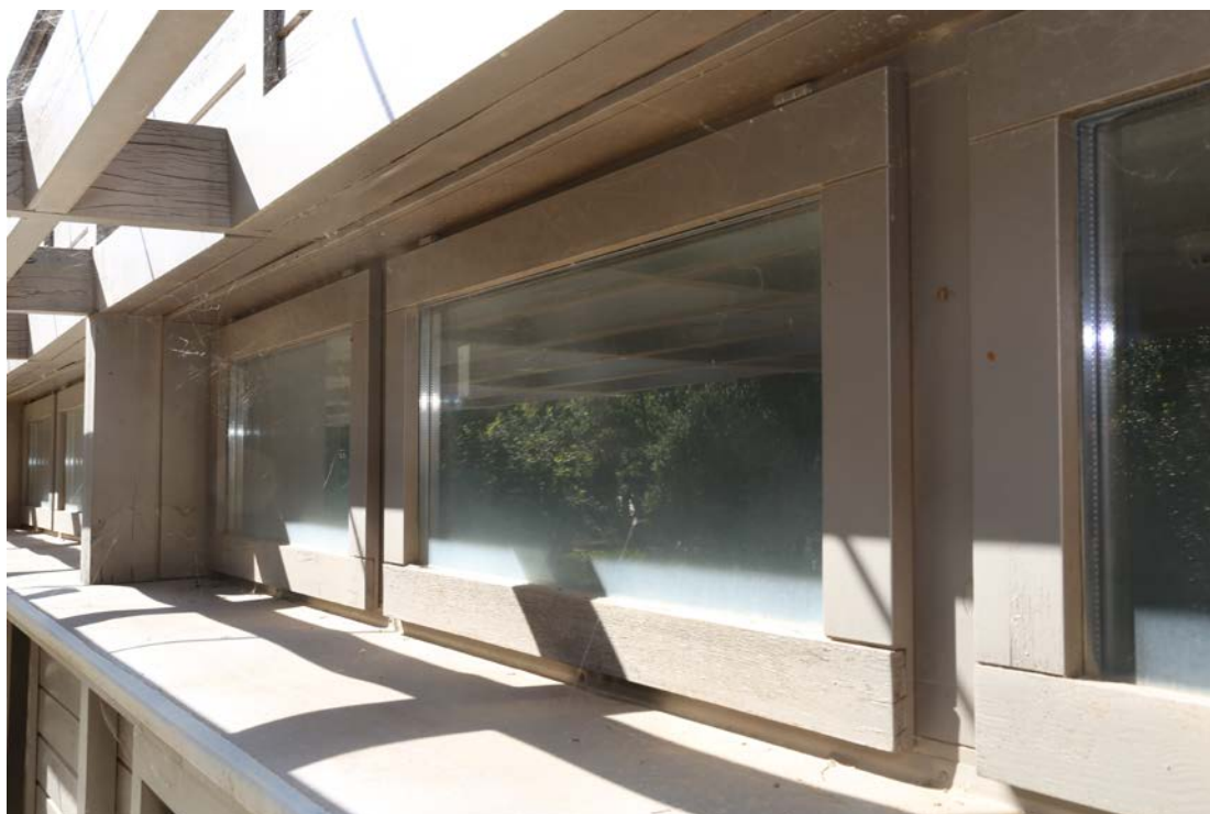
Slika 25. Vijenac prozora ispod rešetke je načinjen kao okviri s tri zaklopna krila s otvaranjem na van. Prozori su pravilno uvučeni od ravnine pročelja, ali se voda, zbog izostanka strehe i nadstrehe, oblino odbija od široke metalne vanjske klupčice i vlaži drvo. Većina prozora je u dobrom stanju i funkcionalna, ali se primjećuje propadanje površinskog sloja krila zbog navlaživanja.
