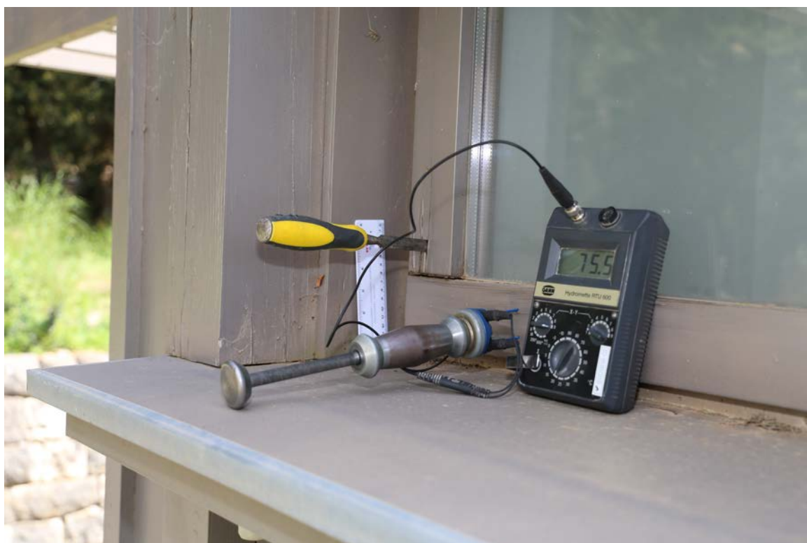
Slika 27. Prozori na sjevernoj strani nisu osunčani, pa je trajno nakupljanje vode kroz čelne presjeke i pukotine na spojevima vrlo intenzivno. Sadržaj vode od 75 % je moguće posljedicom metaboličkog djelovanja gljiva truležnica koje su zahvatile kako donju, tako i vertikalnu okvirnicu krila (zamijeti dlijeto ubodeno po cijelom presjeku trulog drva).
